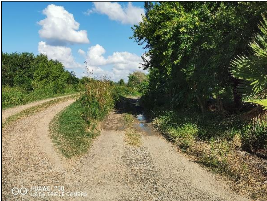
Figura 142. estado inicial de los drenes pluviales
