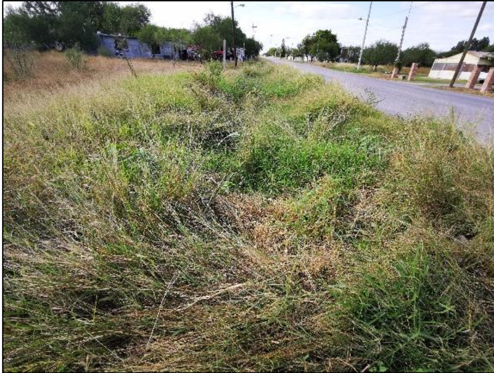
Figura 110. Falta de mantenimiento en la infraestructura pluvial
