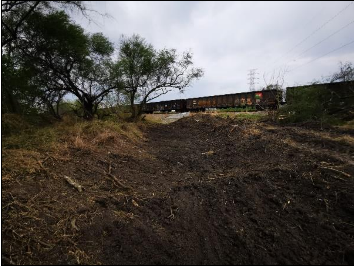
Figura 118. Limpieza de los drenes en las cercanías de las vías del tren
