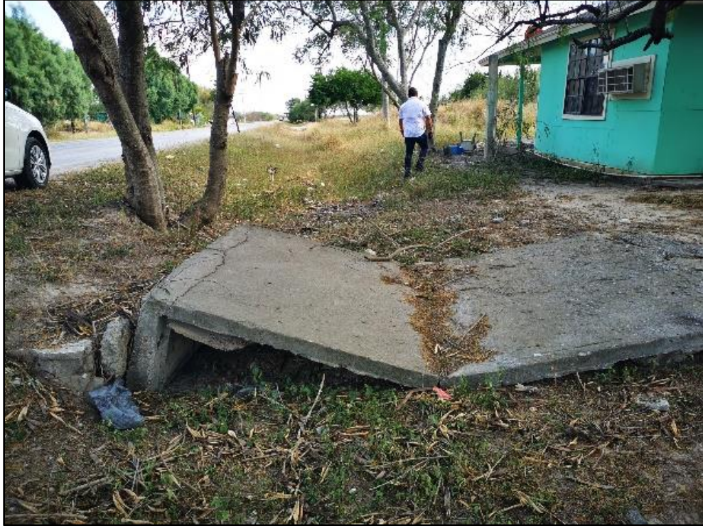
Figura 108. Adecuaciones fallidas en la zona de los drenes
