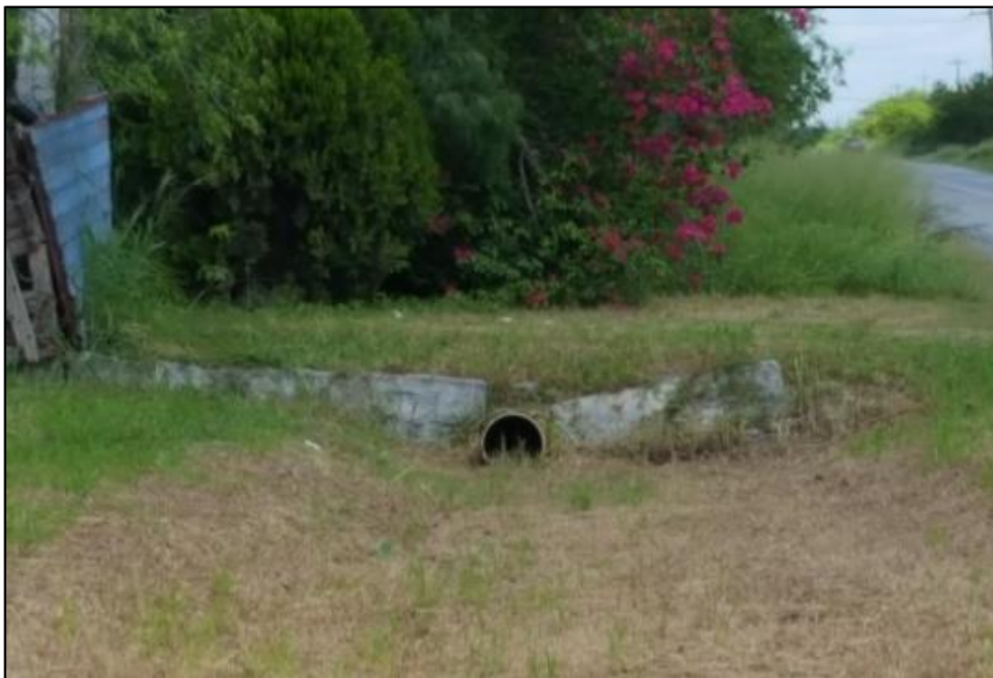
Figura 89. Falta de mantenimiento en drenes pluviales
