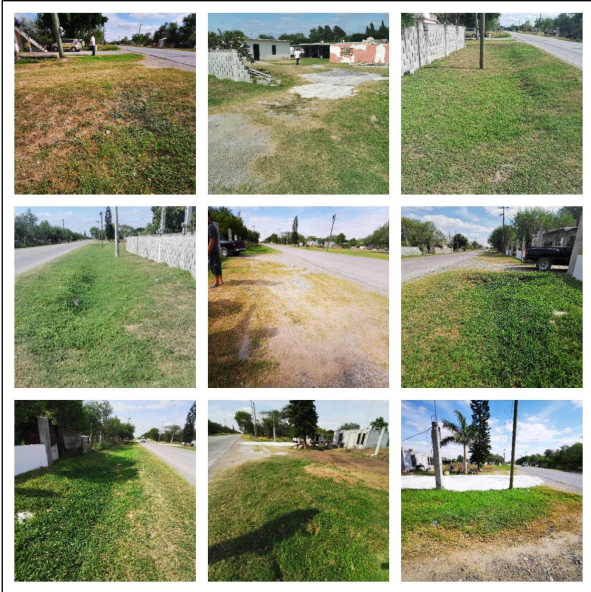
Figura 114. Falta de mantenimiento y abandono de infraestructura pluvial
