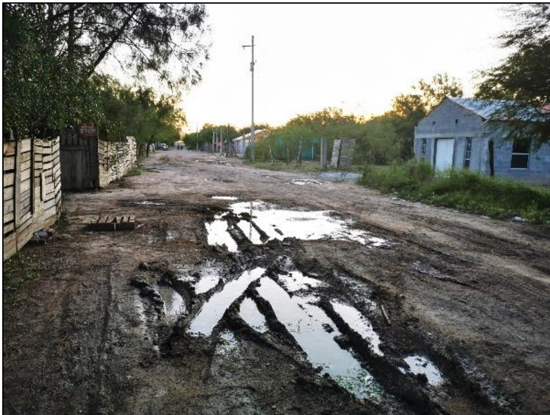
Figura 194. Estado de deterioro en las calles de El Sabinito
