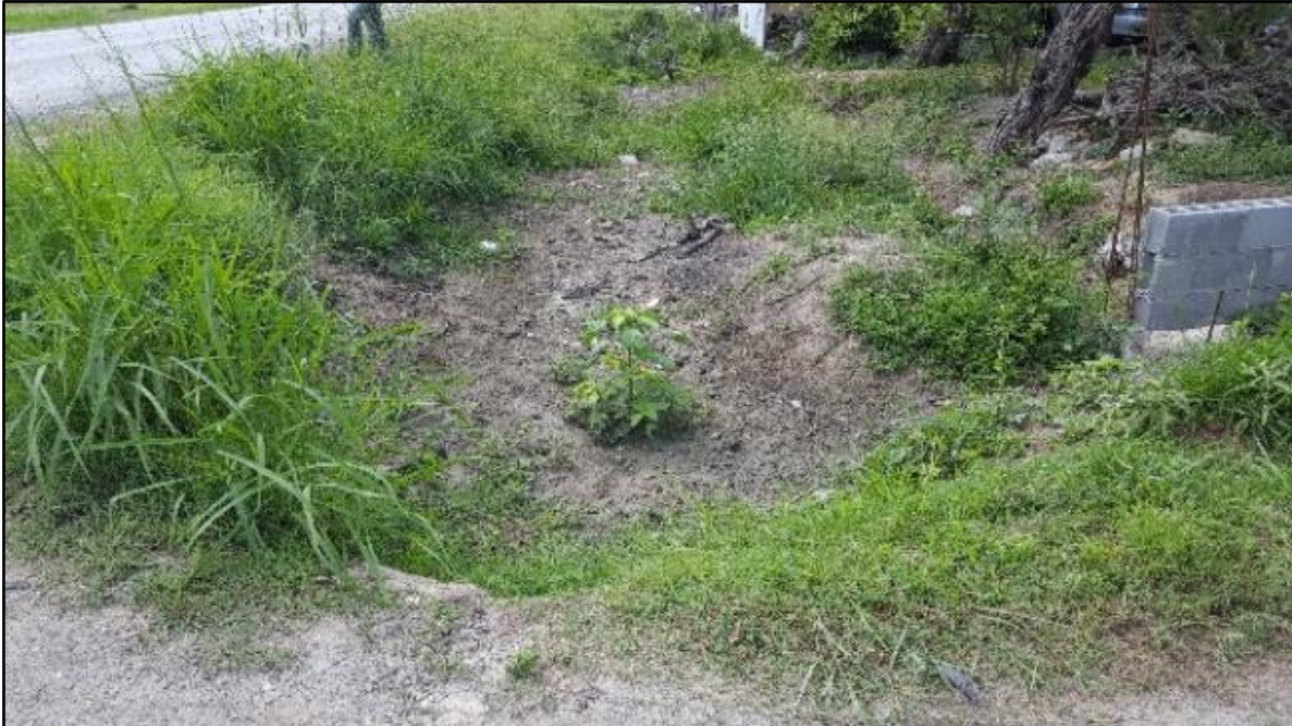
Figura 90. Deterioro en drenes pluviales de Ignacio Zaragoza
