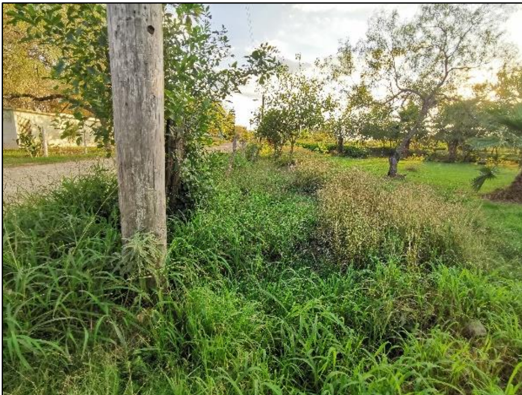
Figura 144. Falta de mantenimiento en drenes pluviales
