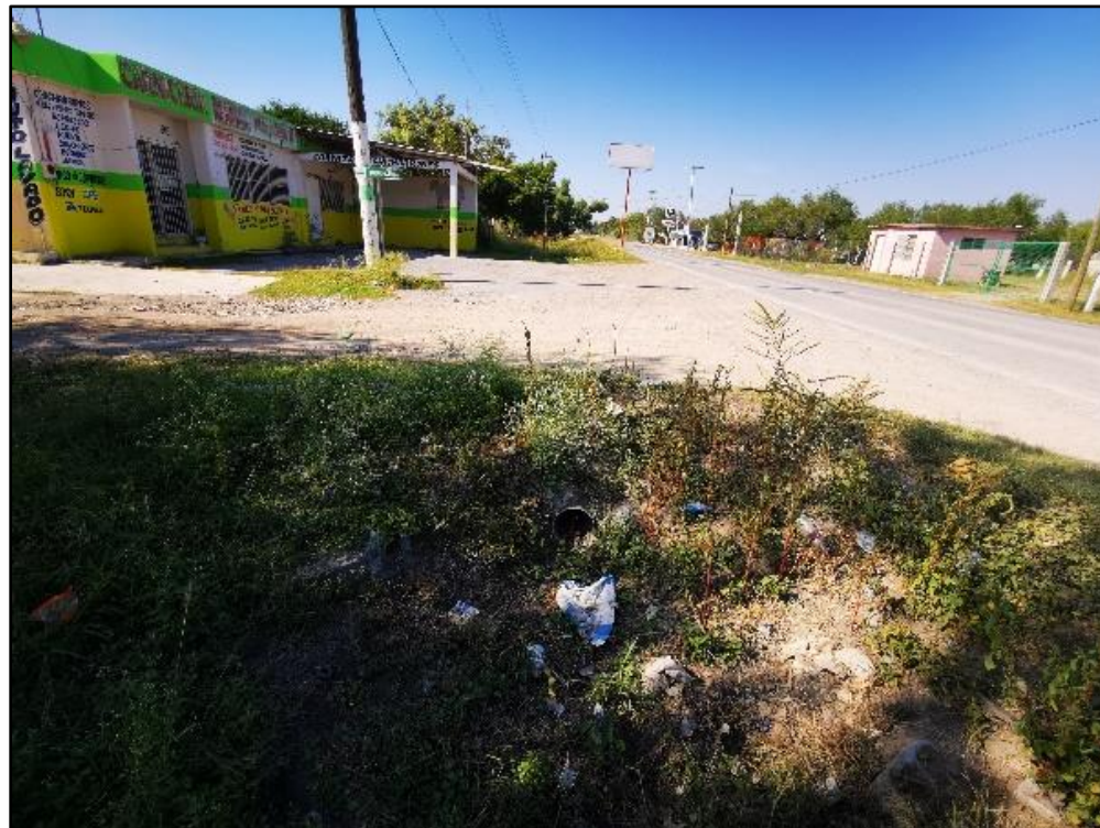
Figura 111. Basura obstruyendo el funcionamiento pluvial
