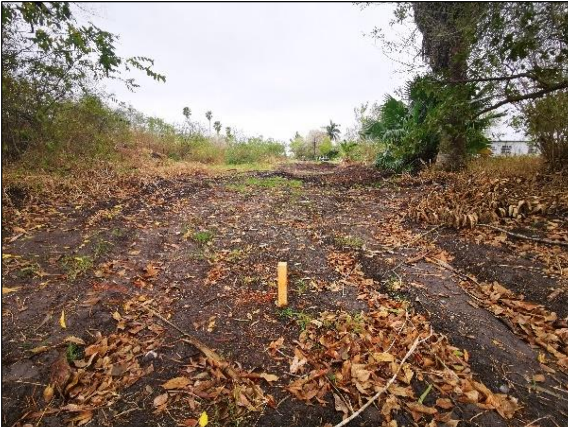
Figura 164. Estado previo de los drenes antes de la instalación de la tubería.
