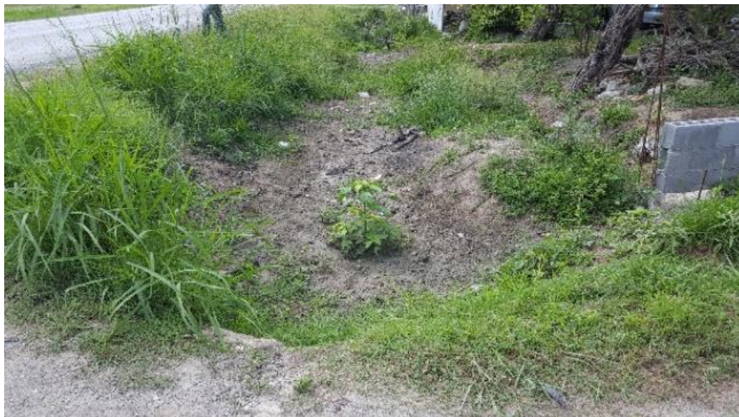
Figura 71. Deterioro en drenes pluviales de Ignacio Zaragoza
