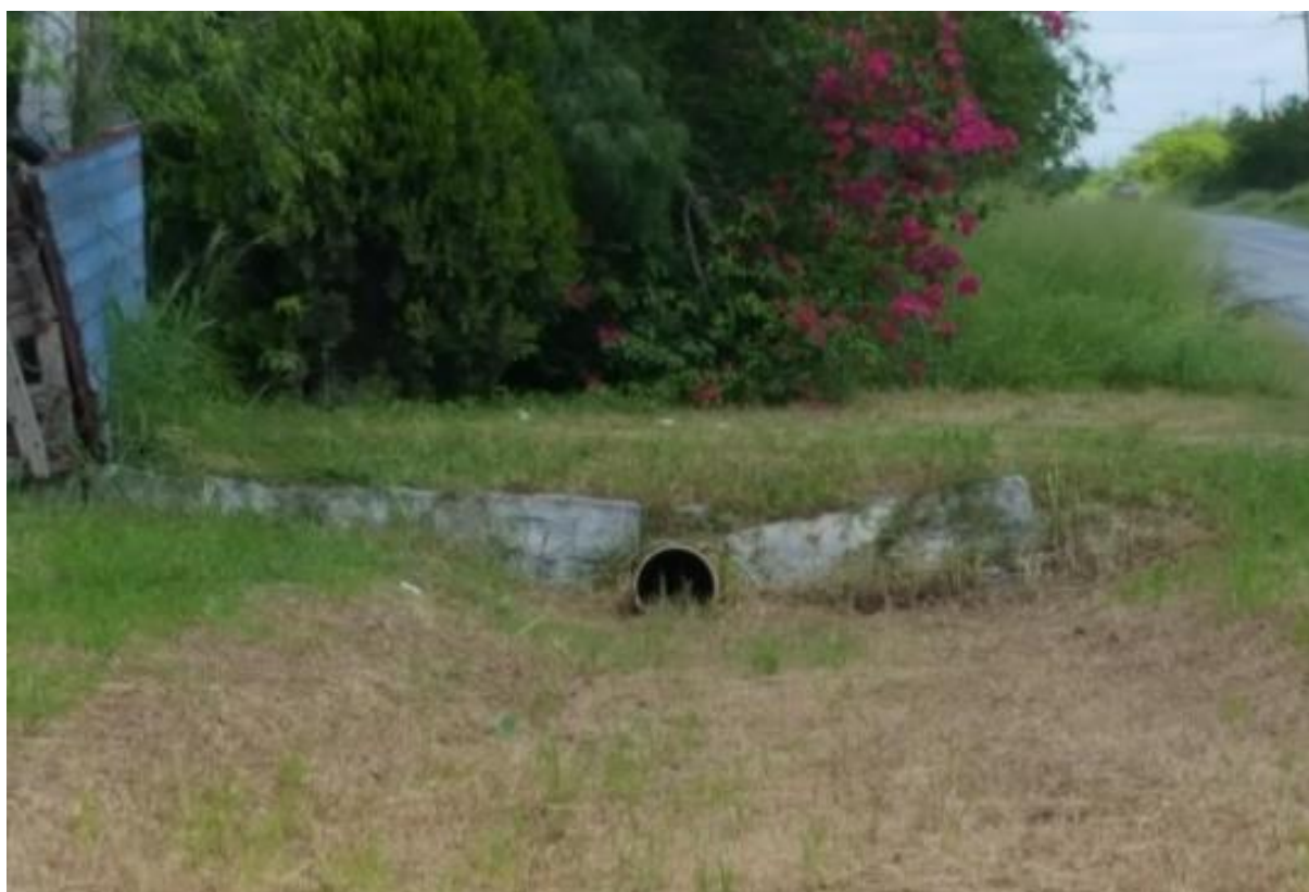
Figura 70. Falta de mantenimiento en drenes pluviales
