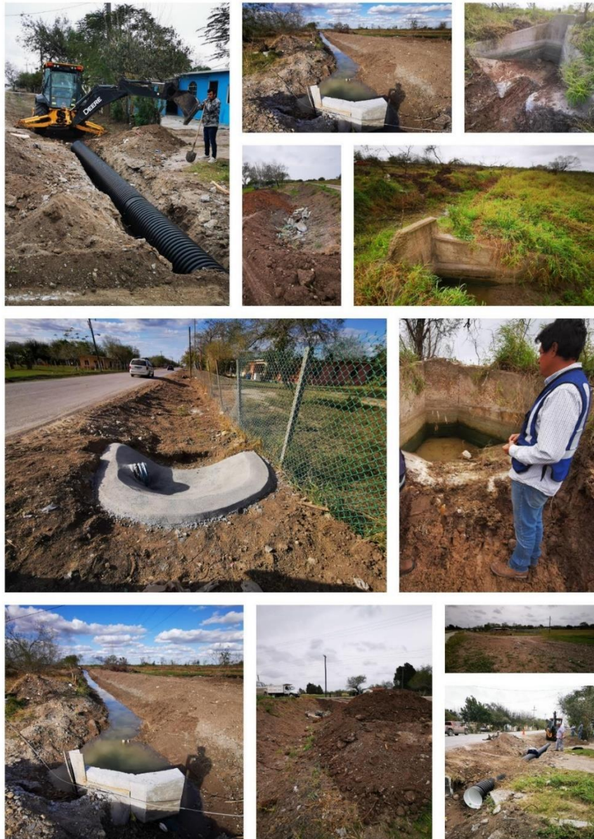
Figura 82. Vista general del avance de obras durante el mes de febrero de 2021
